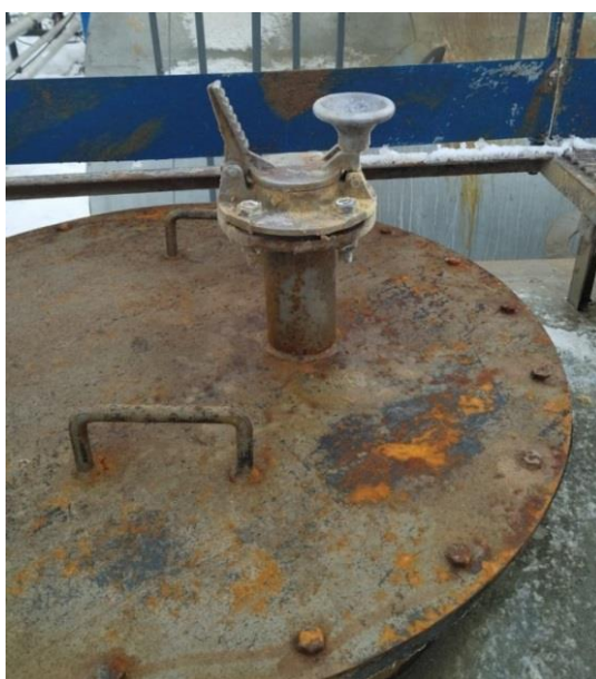
Рисунок 4 – Фото замерного люка резервуаров РГСН-100
