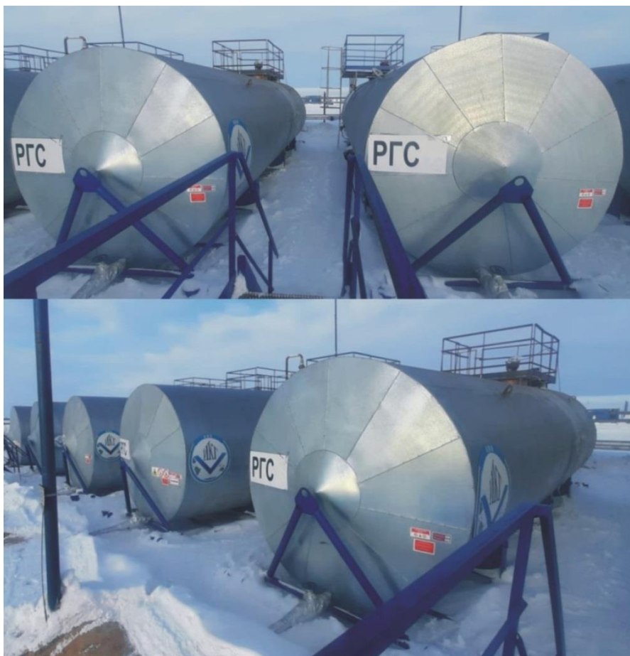
Рисунок 1 – Общий вид резервуаров РГСН-100
