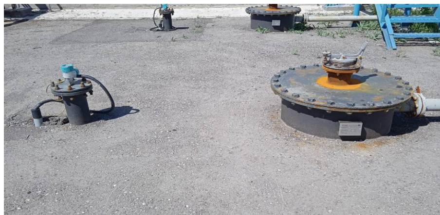
Рисунок 12 – Общий вид резервуара горизонтального стального РГСп-100 заводской номер 19
