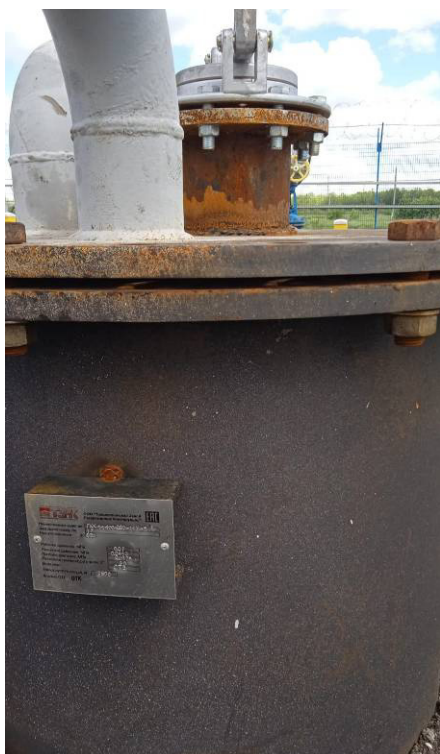
Рисунок 8 – Общий вид резервуара горизонтального стального РГСп-100 заводской номер 17
