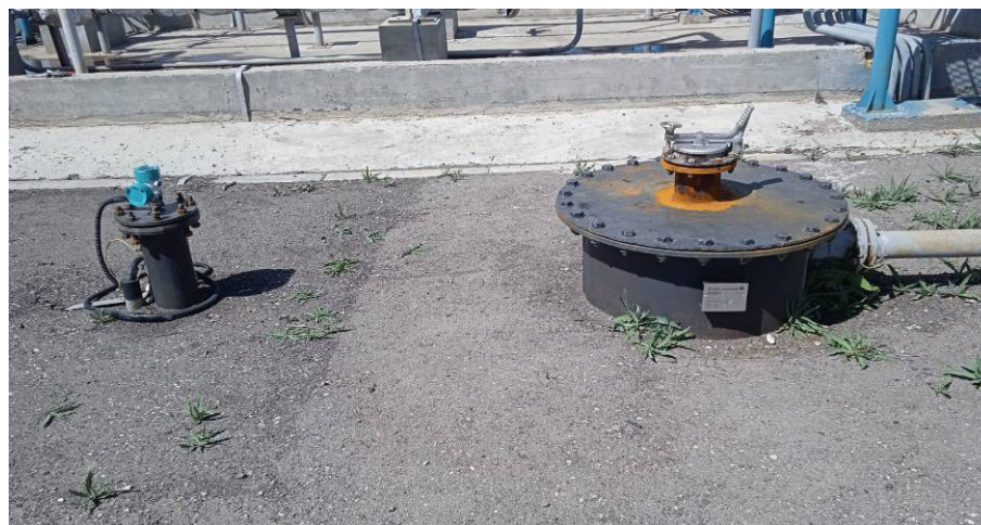
Рисунок 10 – Общий вид резервуара горизонтального стального РГСп-100 заводской номер 18
