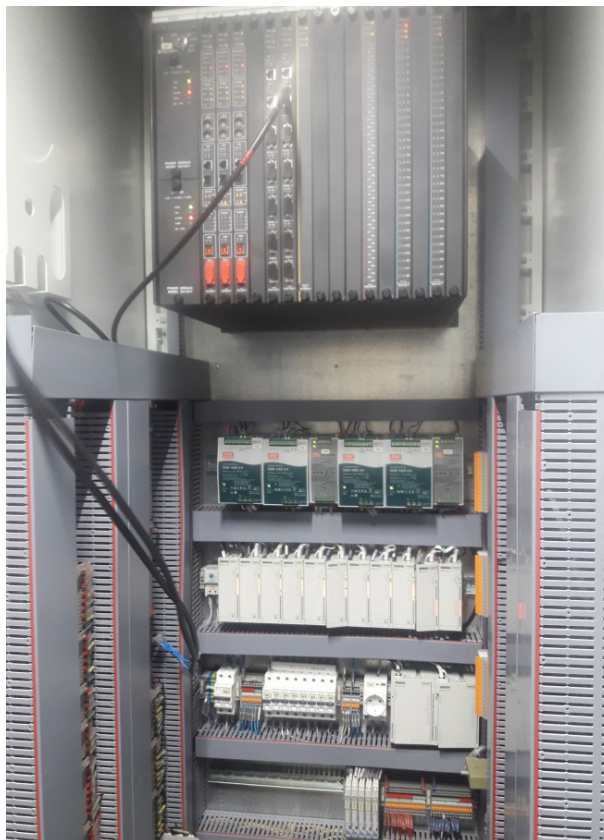
Рисунок 1 - Общий вид электротехнического шкафа комплекса
