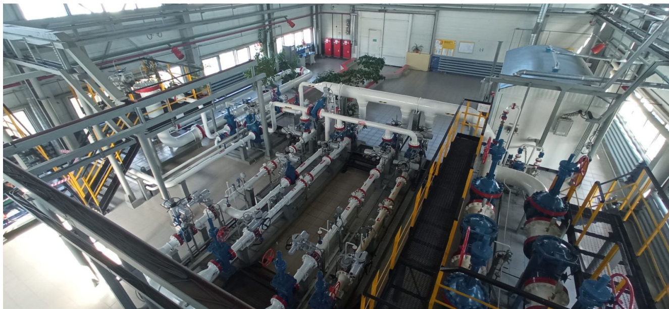
Рисунок 1 – Общий вид СИКН
