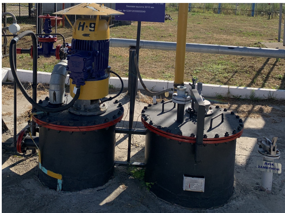
Рисунок 3 – Горловины и измерительный люк резервуара ЕП8-2000-1300-2 зав.№ 4730
