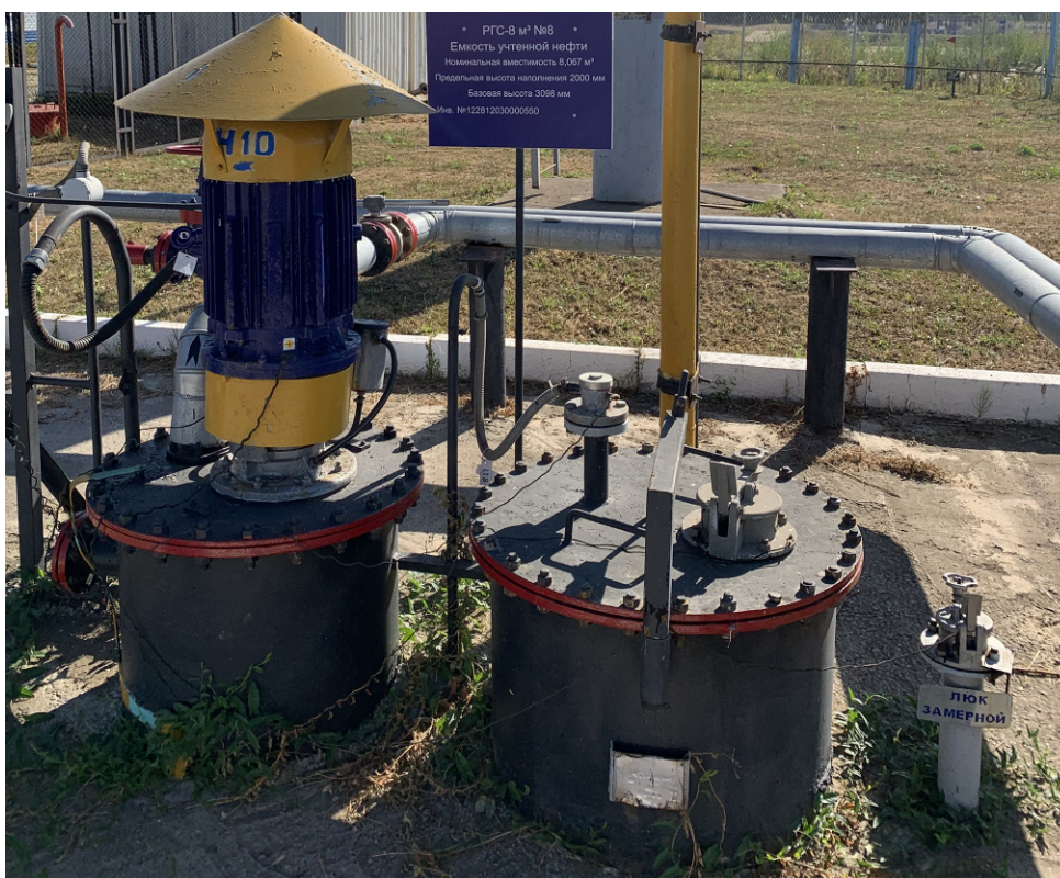
Рисунок 4 – Горловины и измерительный люк резервуара ЕП8-2000-1300-2 зав.№ 4731
