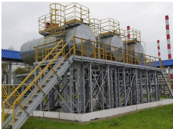
Рисунок 1 – Фотография общего вида резервуаров стальных горизонтальных цилиндрических РГС-20 (17+3)
