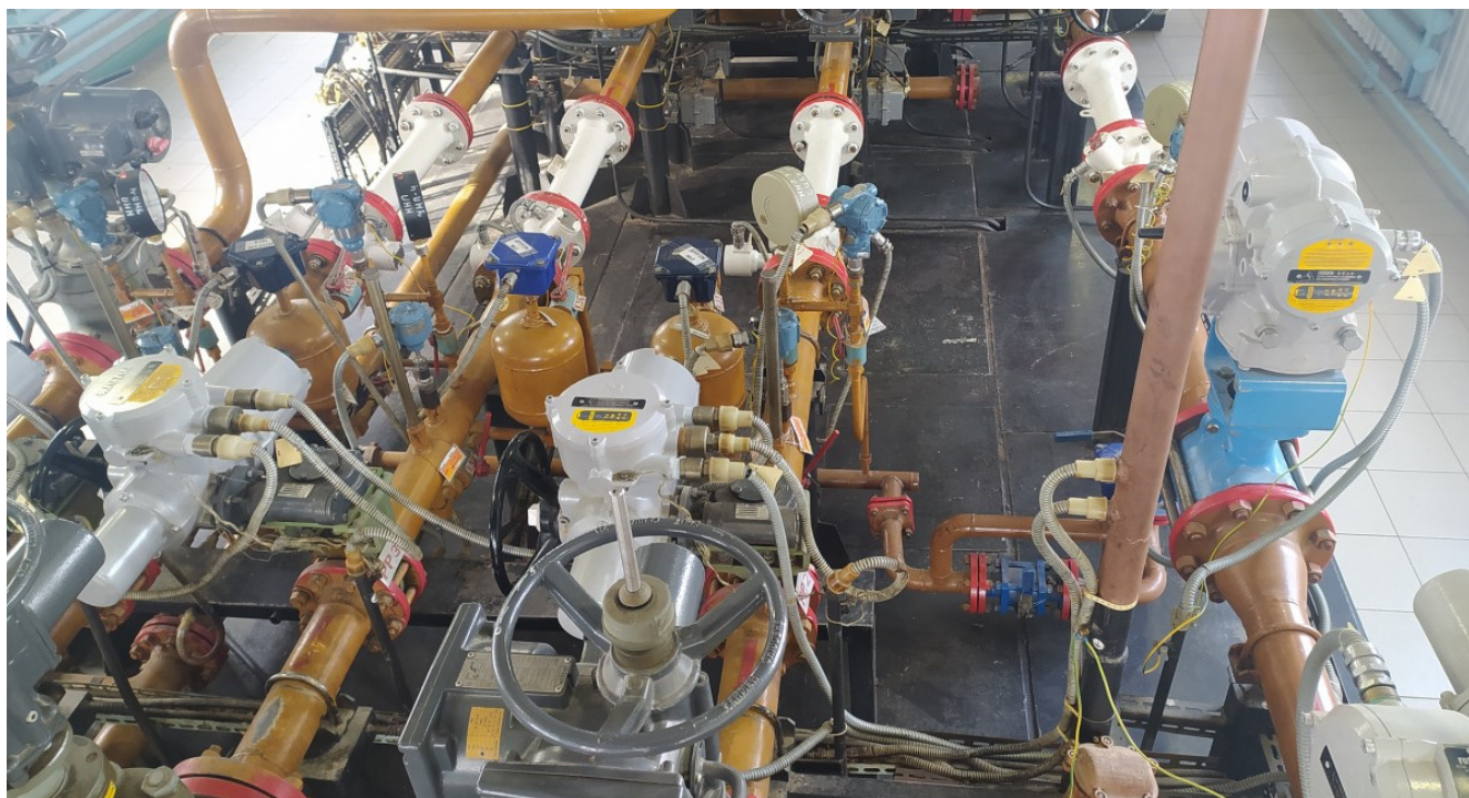
Рисунок 1 – Общий вид СИКН
