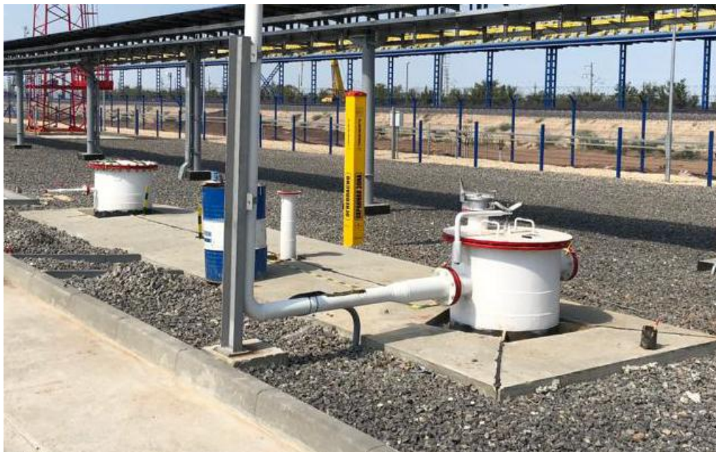
Рисунок 2 - Общий вид места установки резервуара стального горизонтального цилиндрического РГС-100 зав. № 52
