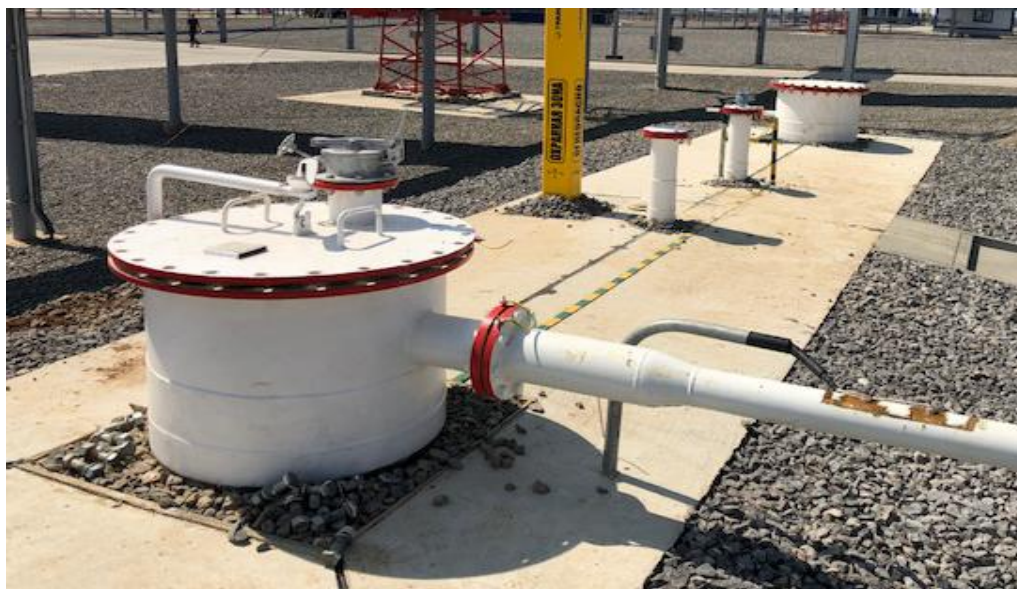
Рисунок 1 - Общий вид места установки резервуара стального горизонтального цилиндрического РГС-100 зав. № 51
