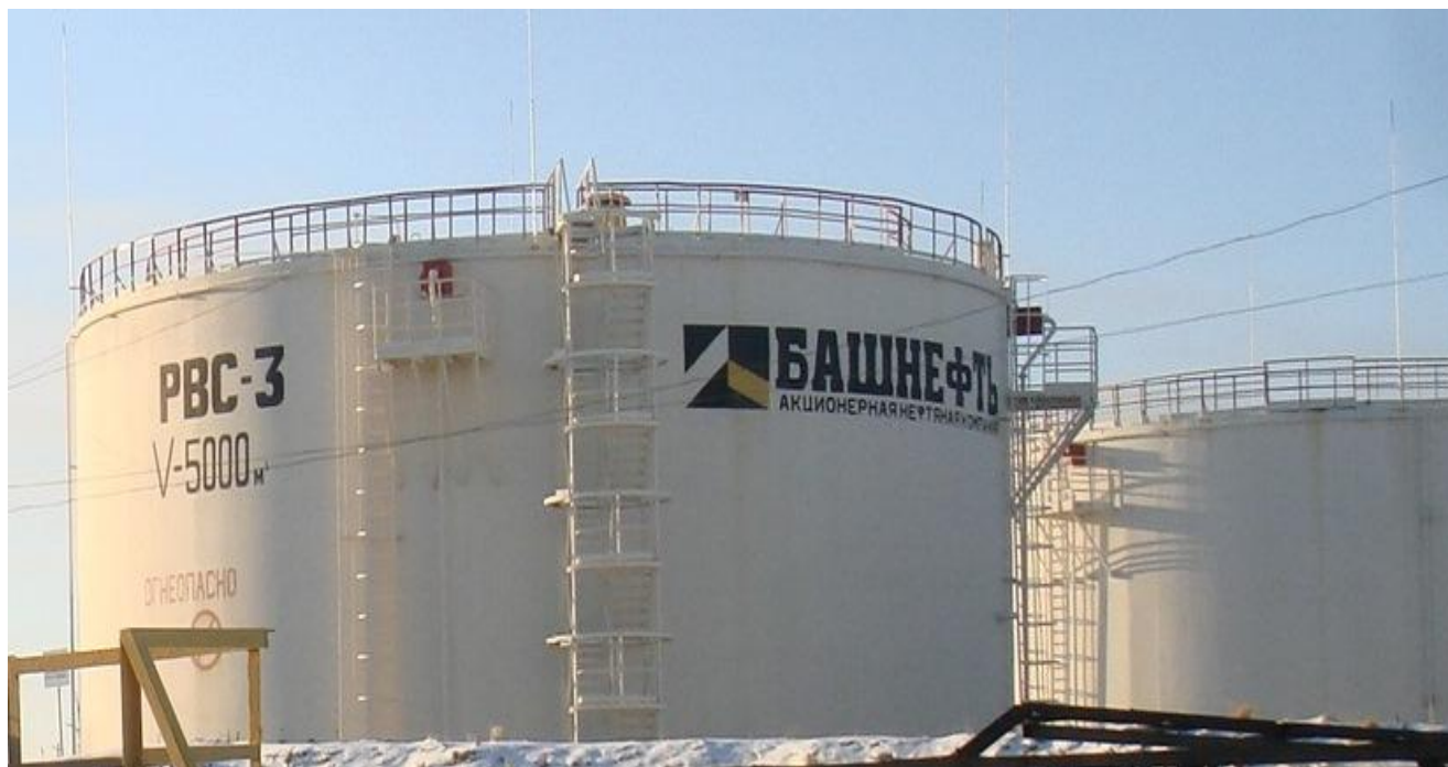
Рисунок 1 - Общий вид резервуаров стальных вертикальных цилиндрических РВС-5000, РВСП-5000
