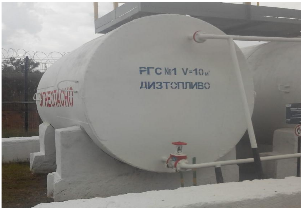
Рисунок 3 - Общий вид резервуара РГС-10 № 3 (НПС «Суходольная»)
