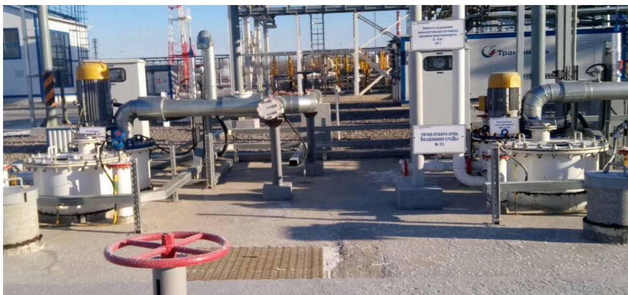
Рисунок 1 - Общий вид места установки резервуаров стальных горизонтальных цилиндрических РГС-8 зав. №№ 6709, 6710
