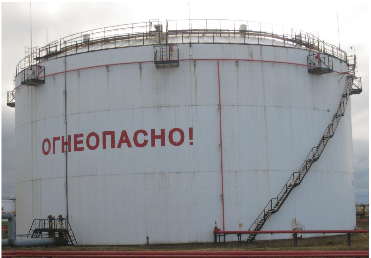
Рисунок 1 - Общий вид резервуара стального вертикального цилиндрического РВСП-20000
