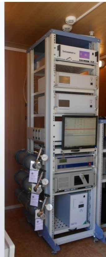
Рисунок 2 – Общий вид поста ПКЗ-А. СИ, установленные в приборную стойку
