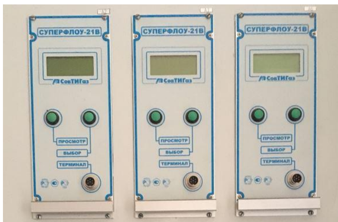
а) вычислители, установленные в шкафу
