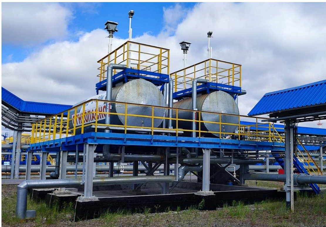
Рисунок 1 – Общий вид резервуаров РГС-20
