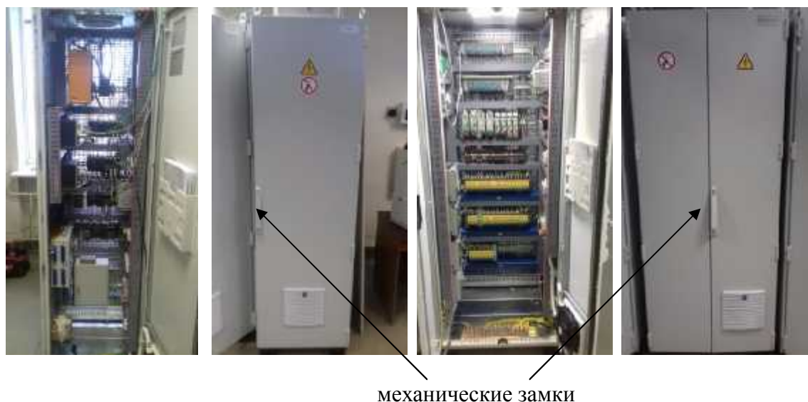
Рисунок 1 - Внешний вид шкафов комплекса
