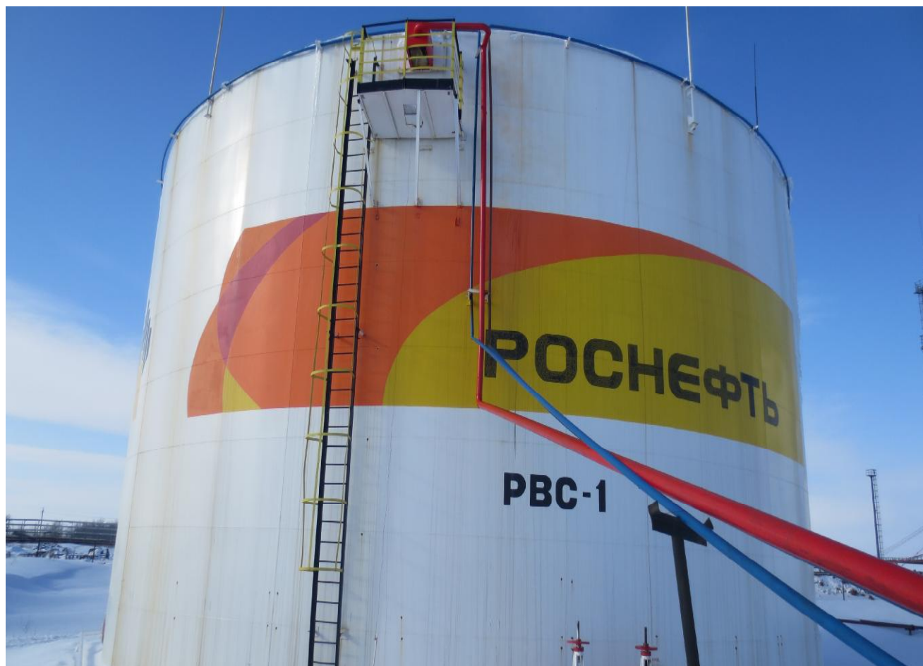
Рисунок 4 - Общий вид резервуара стального вертикального цилиндрического RVC-5000
