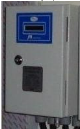
а) вычислитель, установленный в шкафу
