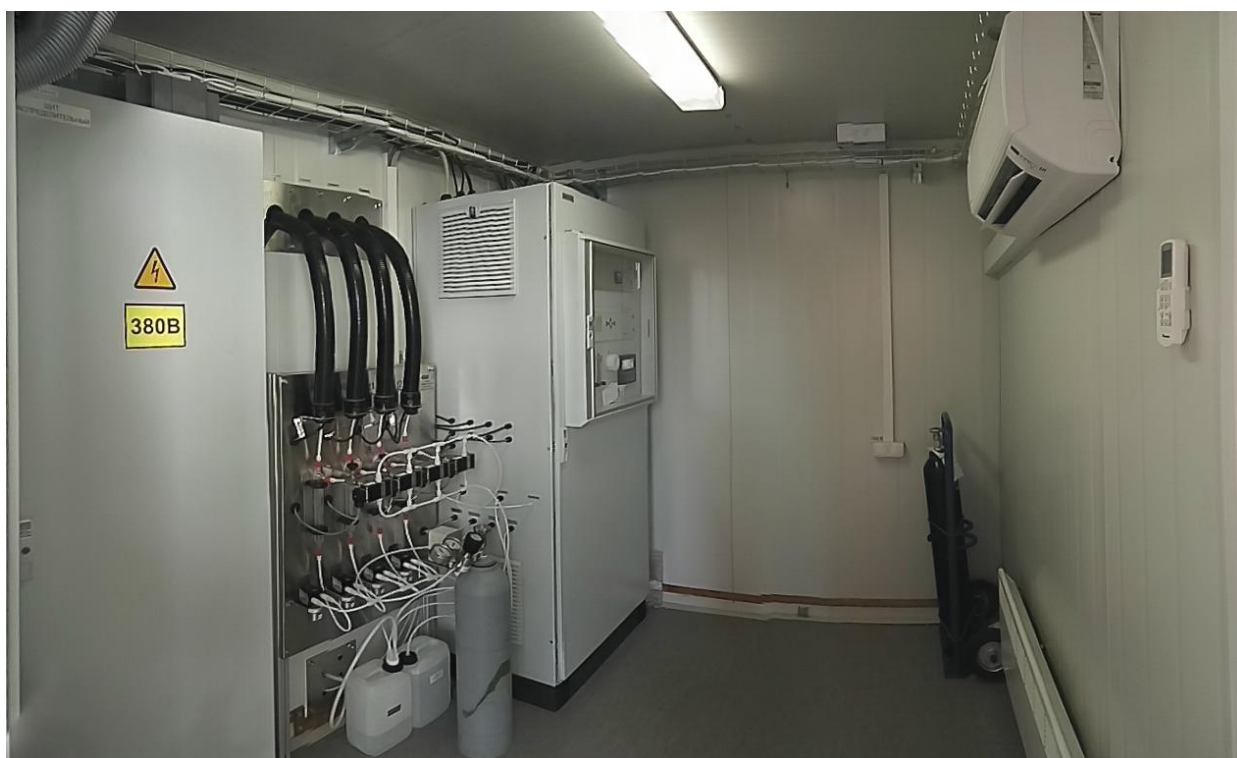
Рисунок 2 - Вид СПКВ внутри контейнера
