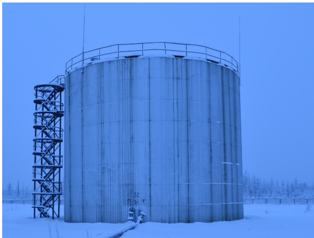
Рисунок 2 - Общий вид резервуара PVC-2000
