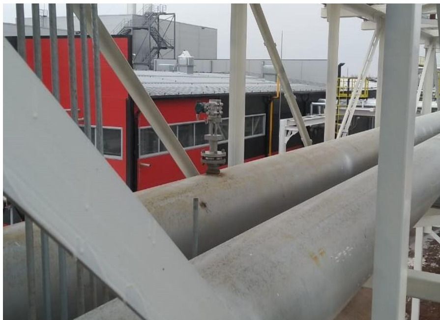
Рисунок 1 – Общий вид комплекса измерительно-вычислительного объема воды на трубопроводе оборотной воды (вход) на эстакаде FT901019 ООО «АЛАБУГА-ВОЛОКНО»
