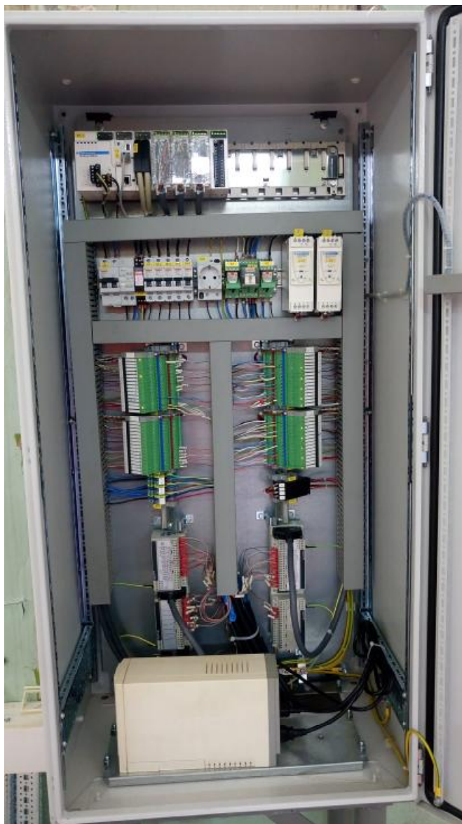
Рисунок 1 - Фотография общего вида шкафа с контроллерами и модулями аналогового ввода
