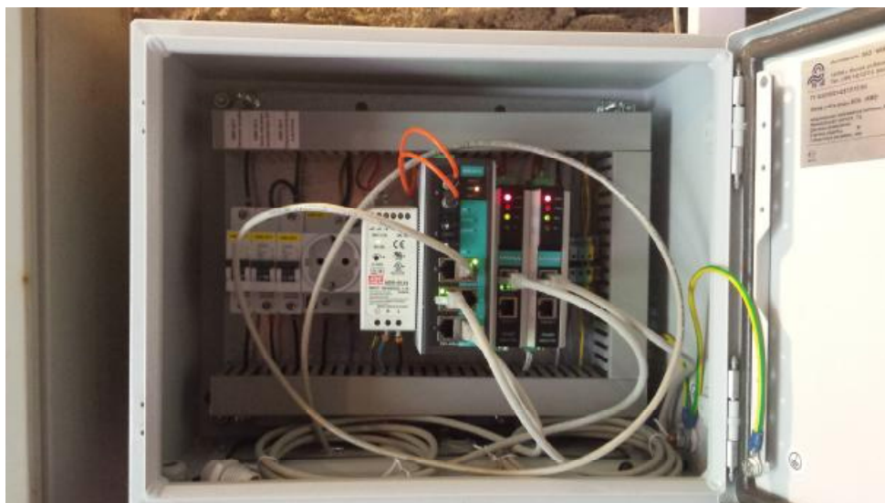
Рисунок 1 - фотография общего вида шкафов учета воды
