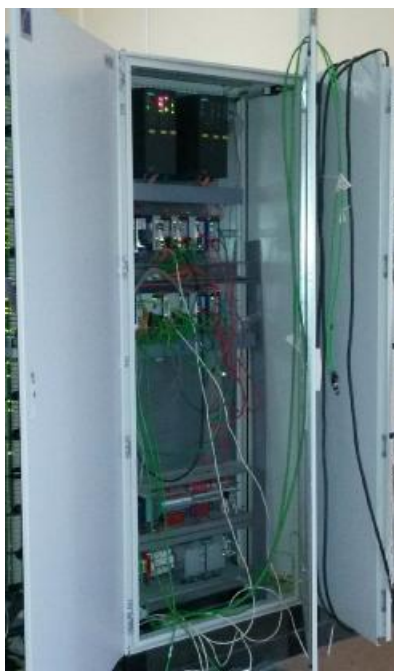
Рисунок 1 – Внешний вид контроллерного шкафа
