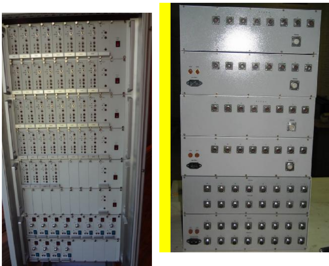
Рисунок 3 - Блоки АСПИ-М/Ш и БПТС (в стойке, вид спереди и сзади)
