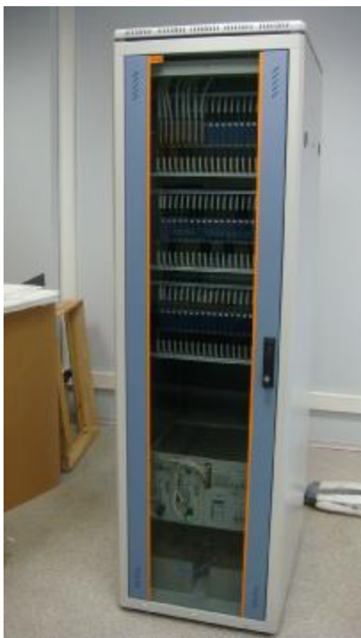
Рисунок 1 - Общий вид оборудования с открытой дверью шкафа
