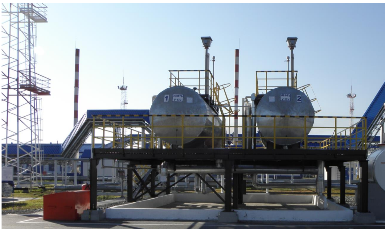
Рисунок 1 – Общий вид резервуаров стальных горизонтальных цилиндрических РГС-20
