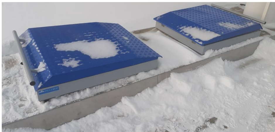
Рисунок 1 – Общий вид видимой части резервуаров PGC-25, PGC-50
