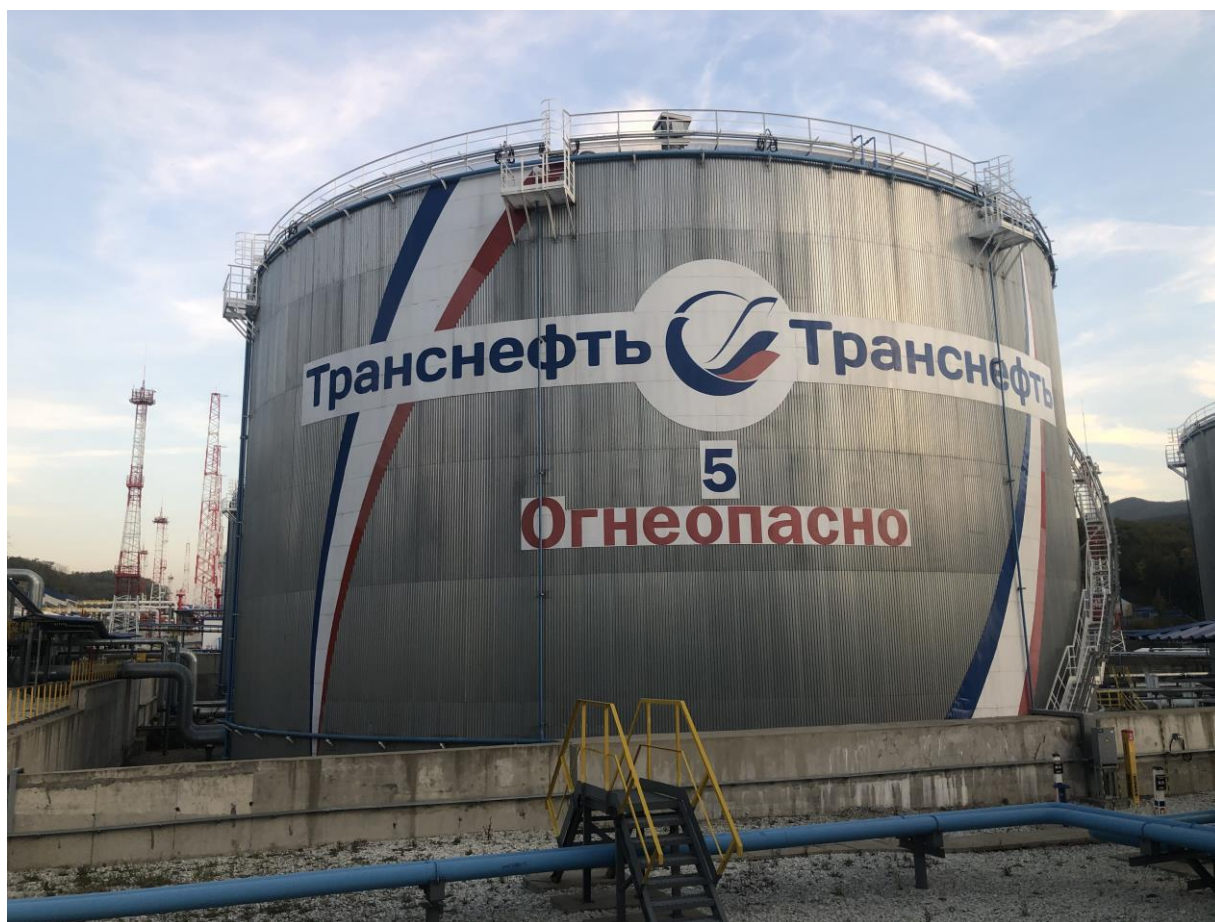
Рисунок 1 – Общий вид резервуаров вертикальных стальных цилиндрических теплоизолированных РВСт-30000
