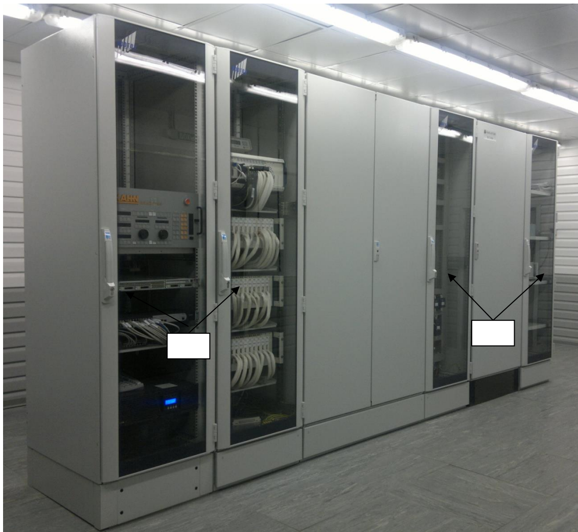
Рисунок 1 – Система измерительная САТУРН-01. Оборудование нижнего уровня
