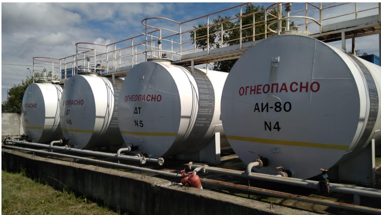
Рисунок 1 – Общий вид резервуаров РГС-75
