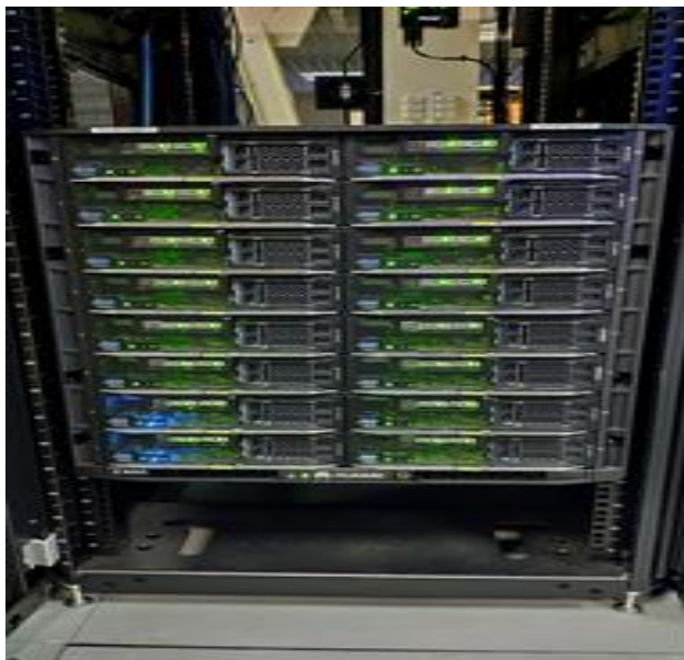
Рисунок 1 – Внешний вид шкафа
