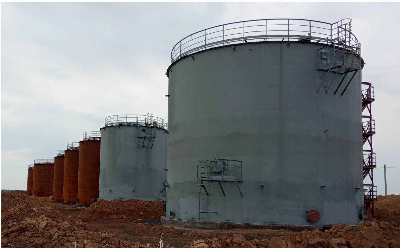
Рисунок 1 – Резервуары вертикальные стальные РВСП-1000, РВСП-2000
