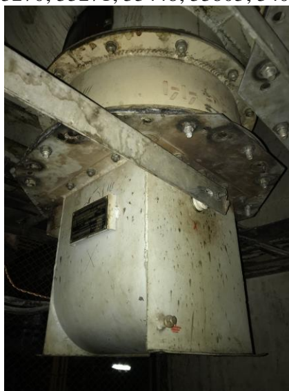
Рисунок 2 – Общий вид трансформаторов напряжения ЗНОМ-20-63 с заводскими номерами: 2; 5; 13; 79; 183; 45512; 45515; 45517; 50461; 50674; 50724; 51667; 58567
