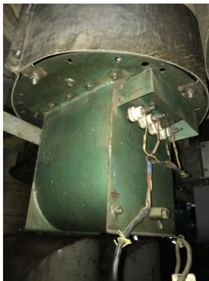
Рисунок 1 – Общий вид трансформаторов напряжения ЗНОМ-20-63 с заводскими номерами: 32324; 32346; 32635; 33270; 33271; 33448; 33803; 34000; 36354; 36367; 38355
