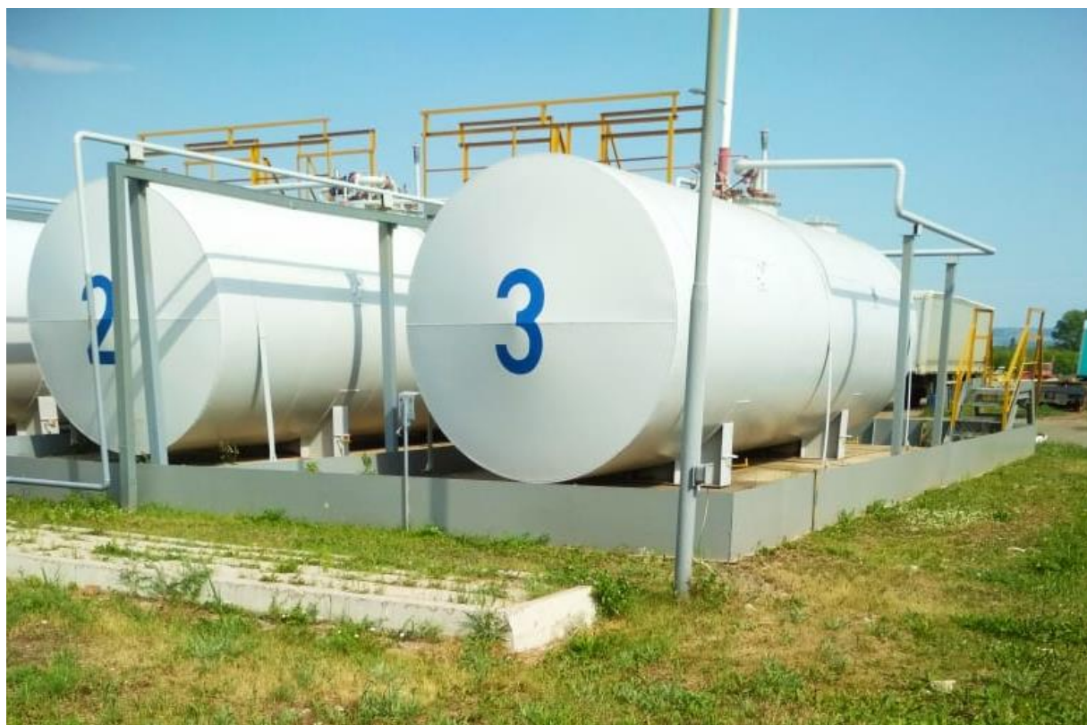
Рисунок 1 – Общий вид резервуаров РГС-50
