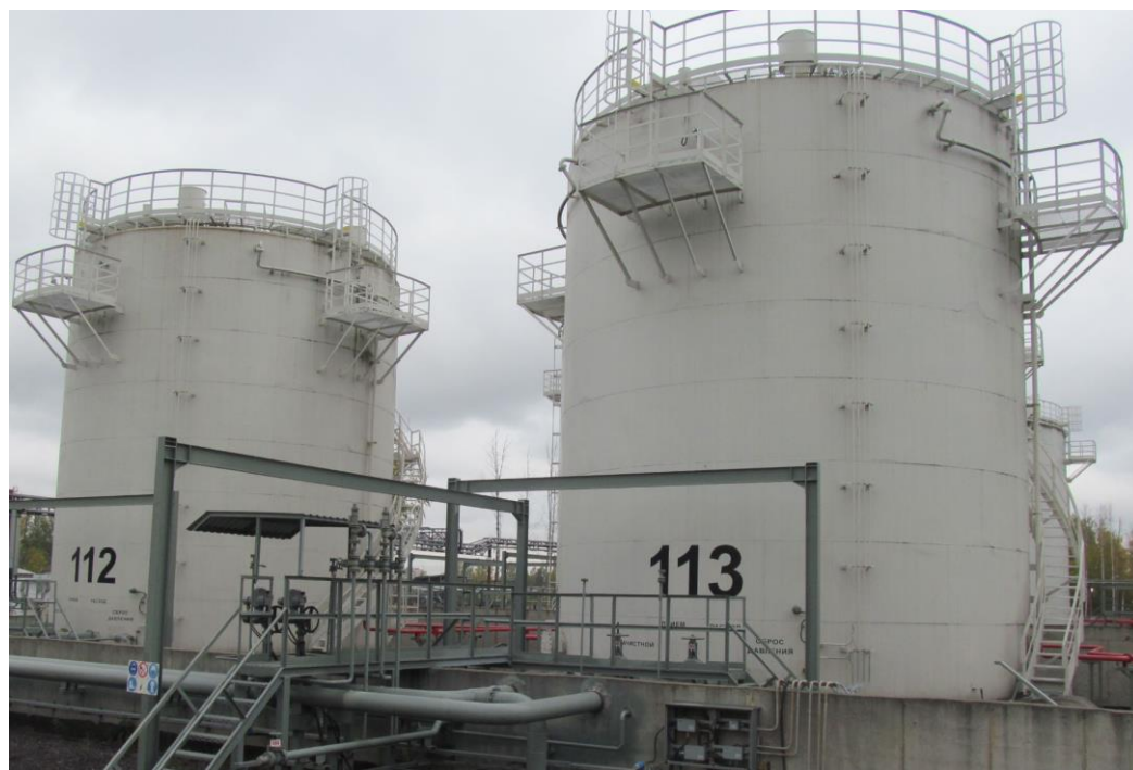
Рисунок 1 – Общий вид резервуаров стальных вертикальных цилиндрических РВСП-1000
