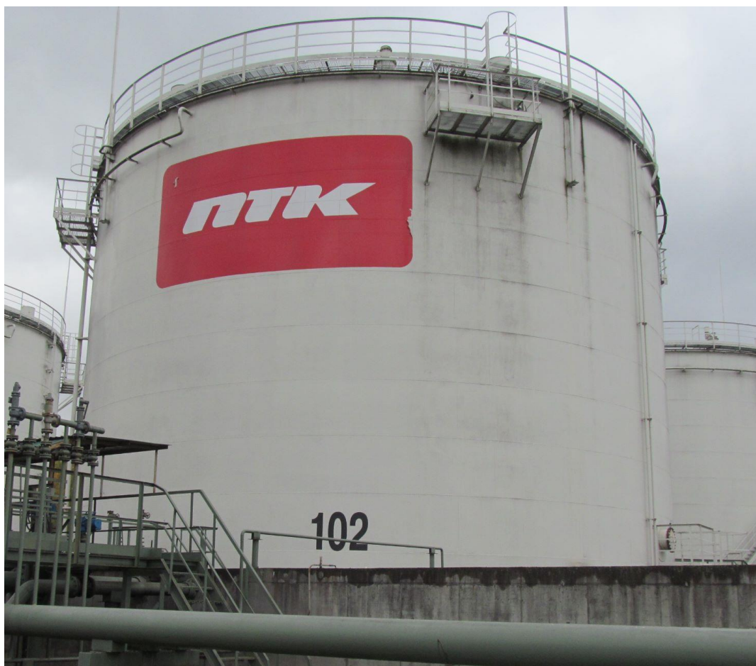
Рисунок 2 – Общий вид резервуаров стальных вертикальных цилиндрических РВСП-4900
