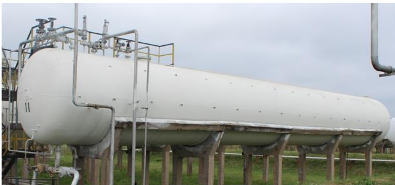
Рисунок 1 – Общий вид резервуаров стальных горизонтальных цилиндрических РГС-175
