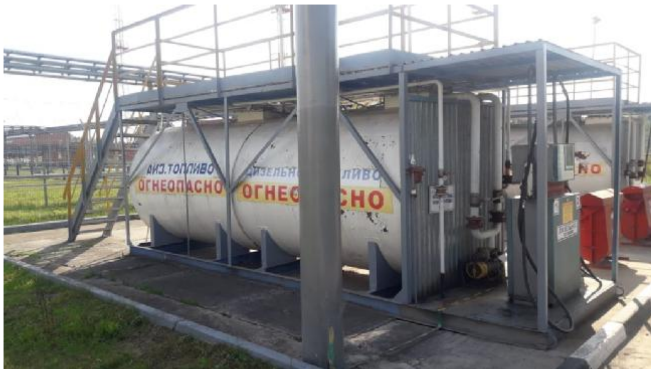
Рисунок 1 – Общий вид резервуаров РГС-10
