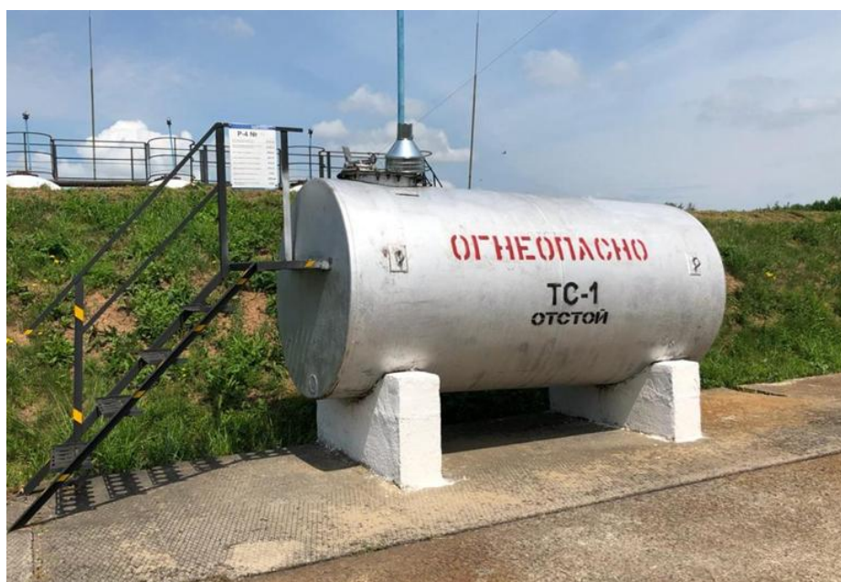
Рисунок 1 – Общий вид резервуаров РГС-4
