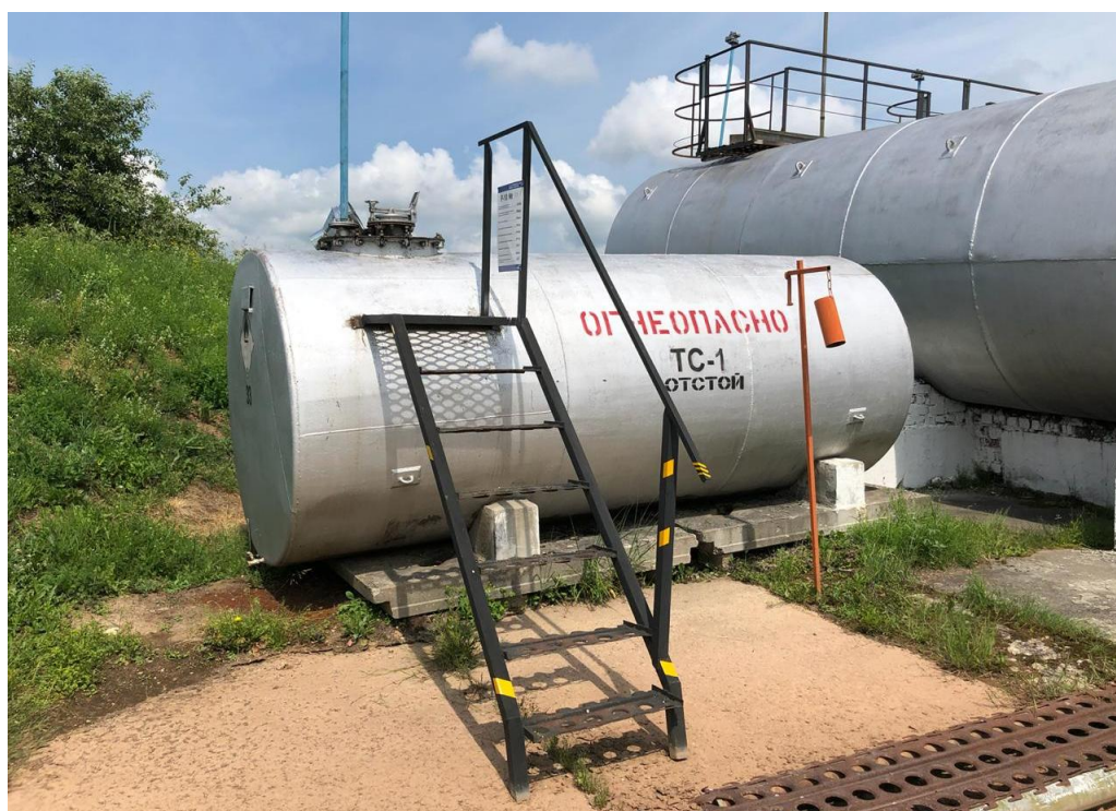
Рисунок 2 – Общий вид резервуаров РГС-10
