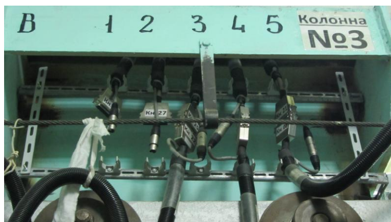
Рисунок 6 – Распределительный щиток для подключения кабелей линий связи
