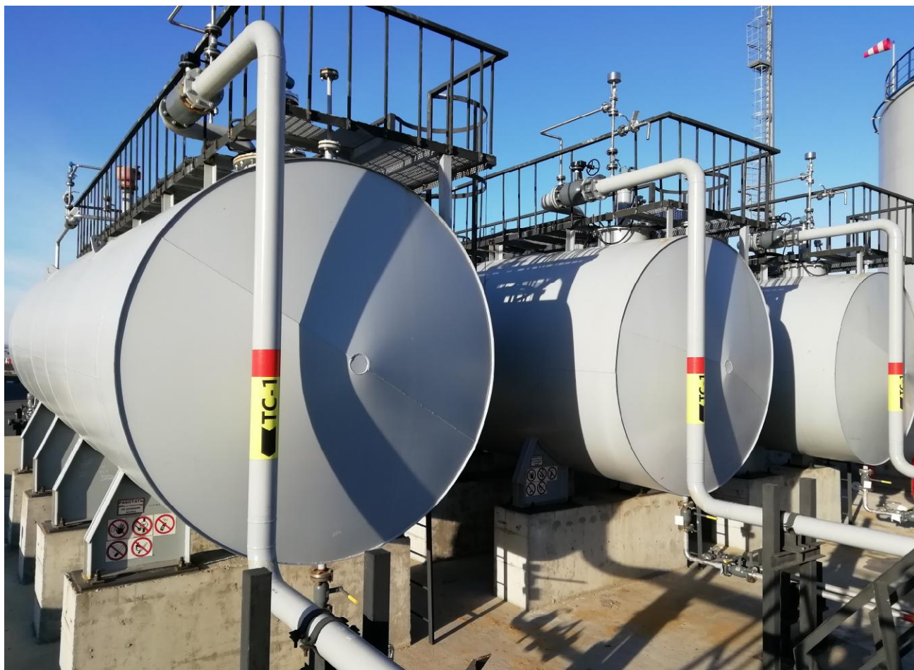
Рисунок 1 - Общий вид резервуаров РГС-50
