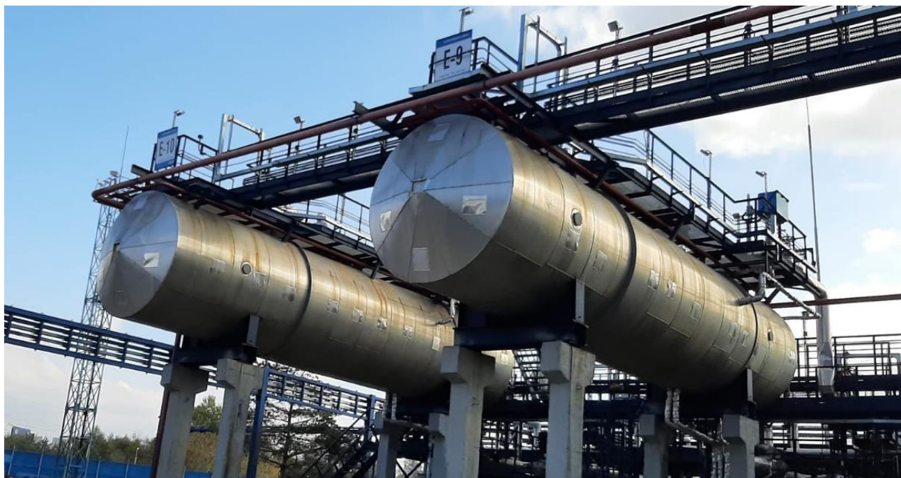
Рисунок 2 – Общий вид резервуаров РГС-100
