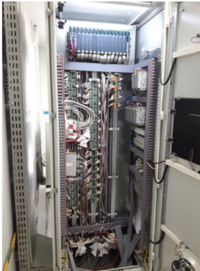
Рисунок 1 – Общий вид электротехнического шкафа системы
