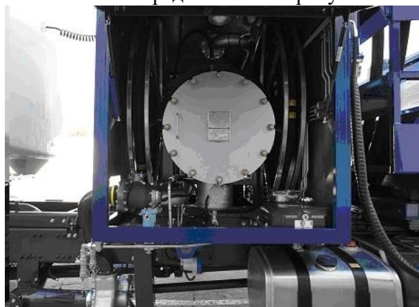
Рисунок 2 – Общий вид системы сзади на средстве заправки
