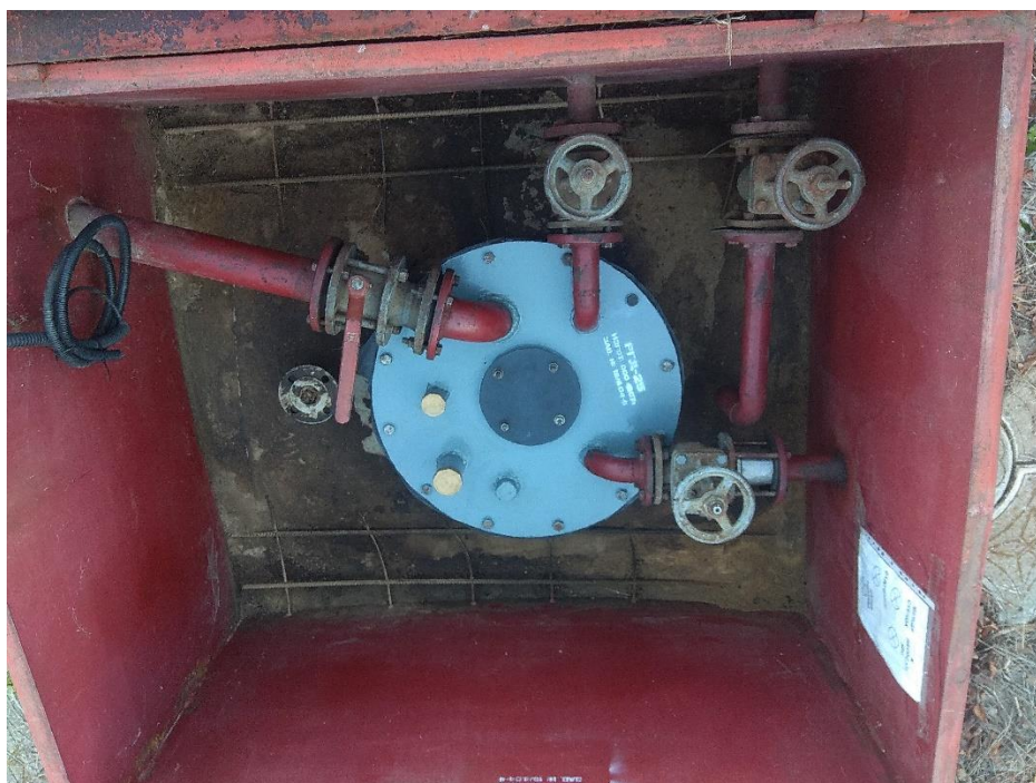
Рисунок 2- Фотография крышки замерного люка резервуара стального горизонтального цилиндрического двустенного РГД-25 заводской номер 19/4.04-01
