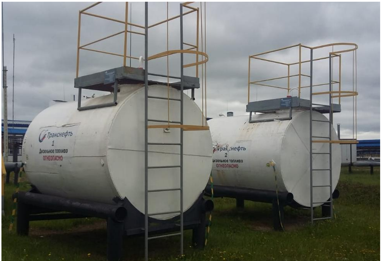
Рисунок 1 - Общий вид резервуаров стальных горизонтальных цилиндрических РГС-10
