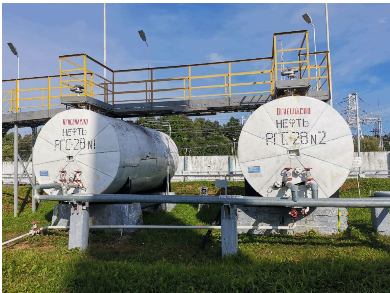
Рисунок 1 – Общий вид резервуаров РГС-28
