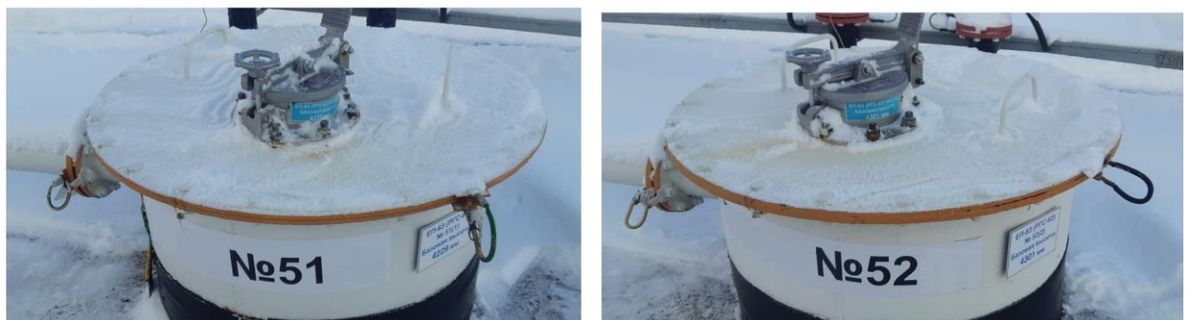
Рисунок 1 – Общий вид резервуаров РГС-63 с заводскими номерами 51, 52
