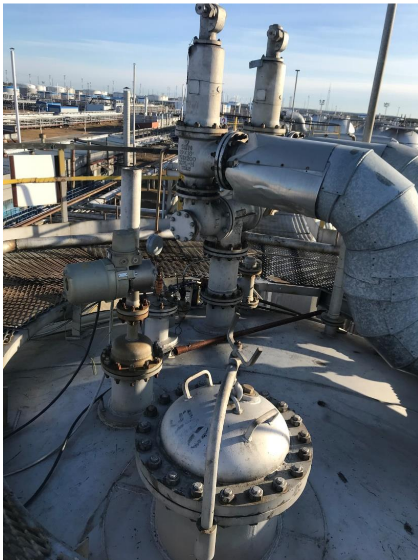
Рисунок 17– Общий вид резервуаров РИС-600
