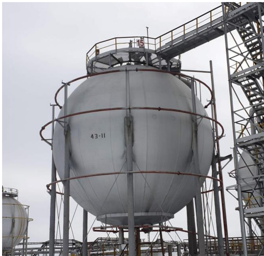
Рисунок 6– Общий вид резервуаров РИС-600
