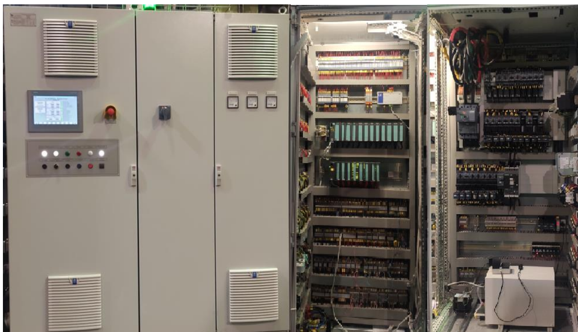
Рисунок 1 – Общий вид щита управления испытательным стендом редуктора БРП
